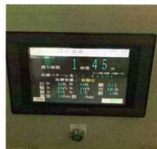
換気量や温度はタッチパネル操作
